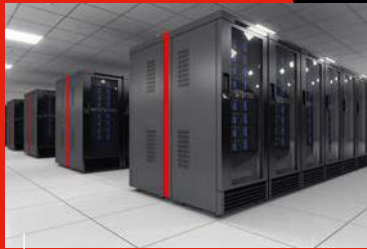
Salles de serveurs
