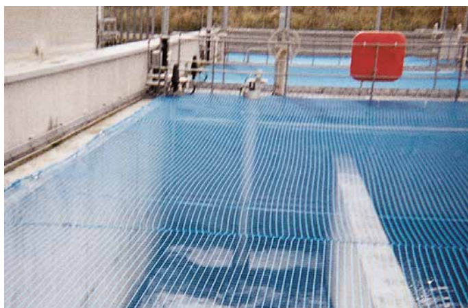
Filet de sécurité sur un bassin d'épuration
